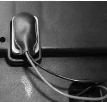
9-V-Blockbatterie für die Notabsenkung
